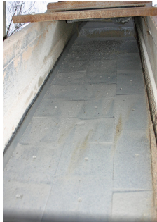
Abbildung: Rutsche zwischen zwei Förderbändern in einem Kieswerk Nähe Lübeck
